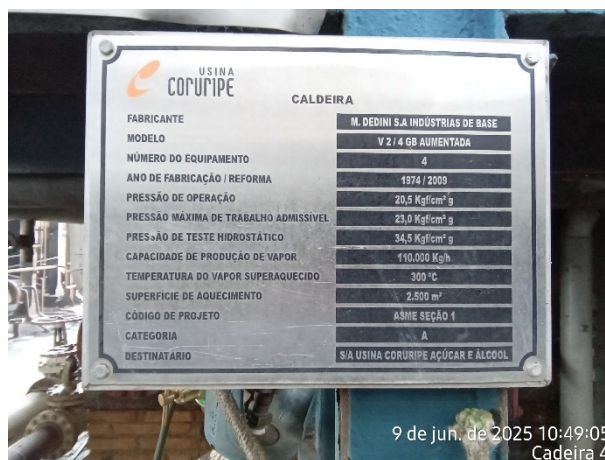
Nameplate data: Boiler nº 4 Coruripe Usina (COR)
