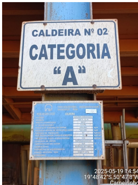
Nameplate data: Boiler nº 2
