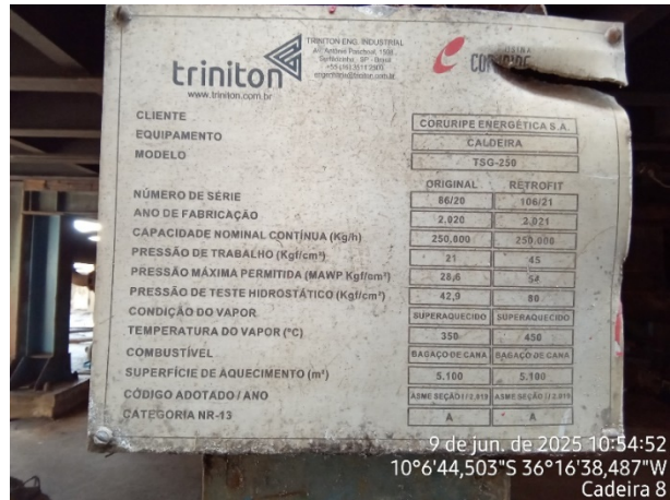
Nameplate data: Boiler nº 8 Coruripe Energética (CVW)
