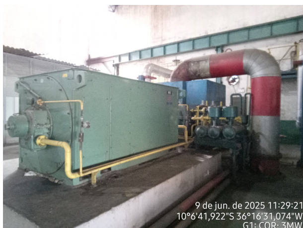
Alternator/ Generator nº 1 (UTE Coruripe Usina COR)
