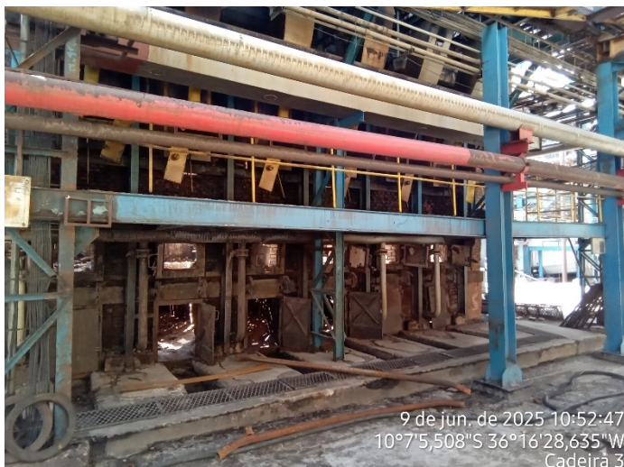
Boiler nº 3 Coruripe Usina (COR)
