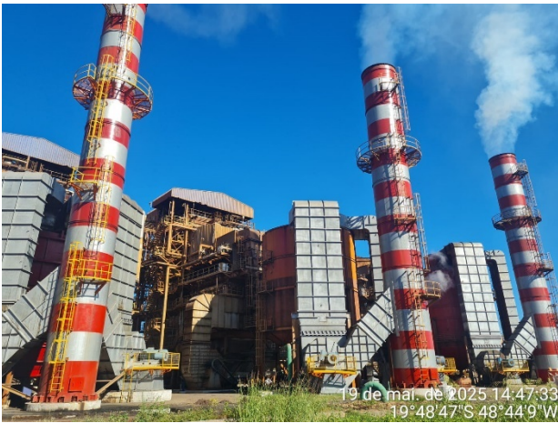
Boilers nº 1, 2 and 3
