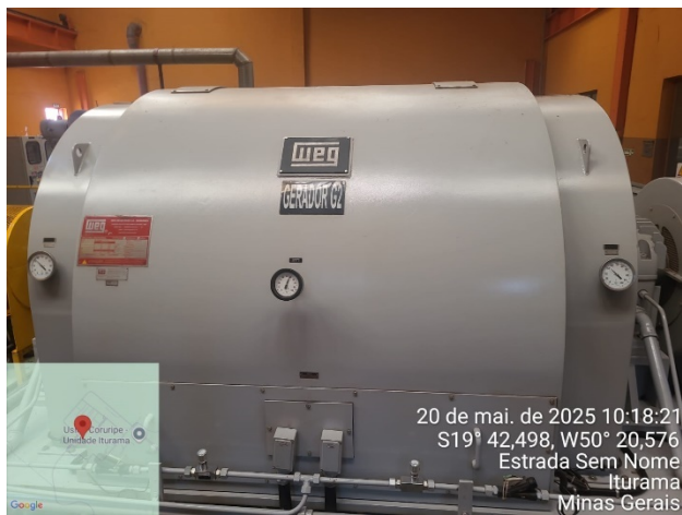
Alternator/ Generator nº 2 (UTE Coruripe Energética Iturama)
