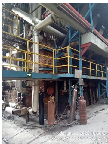
Boiler nº 4 Coruripe Usina (COR)
