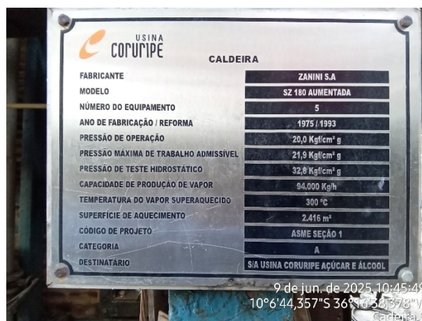
Nameplate data: Boiler nº 5 Coruripe Usina (COR)
