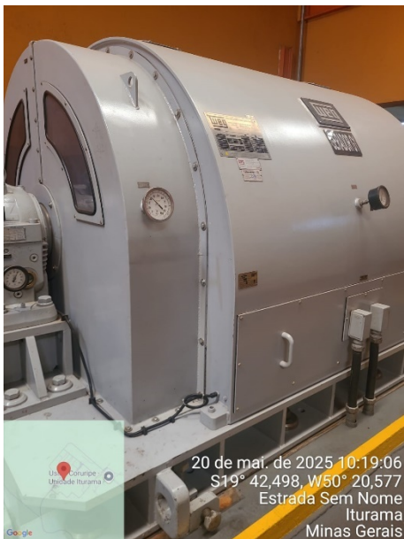
Alternator/ Generator nº 1 (UTE Coruripe Energética Iturama)
