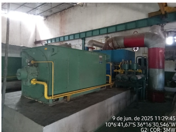
Alternator/ Generator nº 2 (UTE Coruripe Usina COR)
