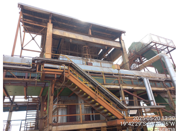
Boiler nº 3 Energética Iturama
