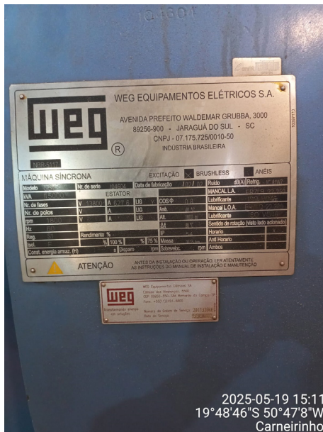
Nameplate data: Alternator/ Generator nº 2
