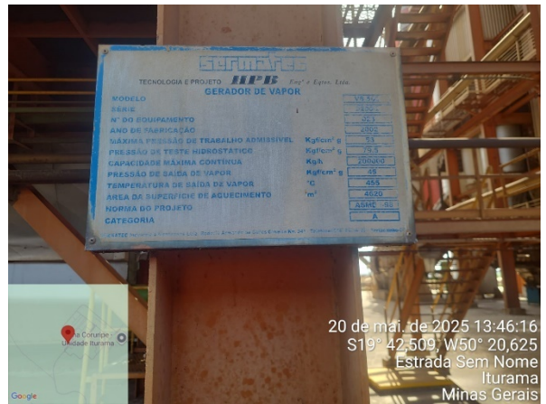
Nameplate data: Boiler nº 3 Energética Iturama
