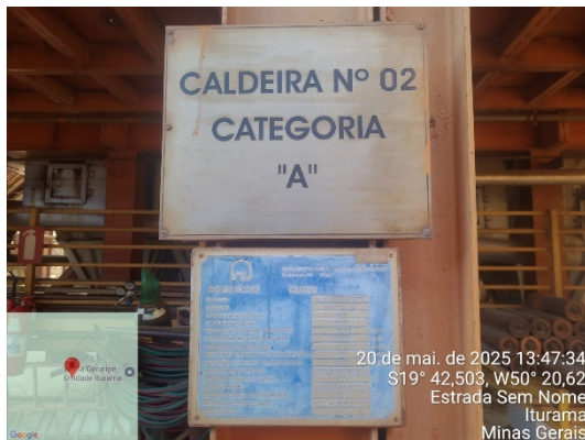
Boiler nº 2 Iturama
