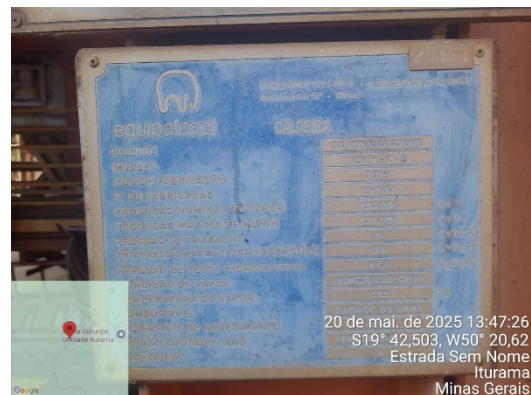
Nameplate data: Boiler nº 2 Iturama
