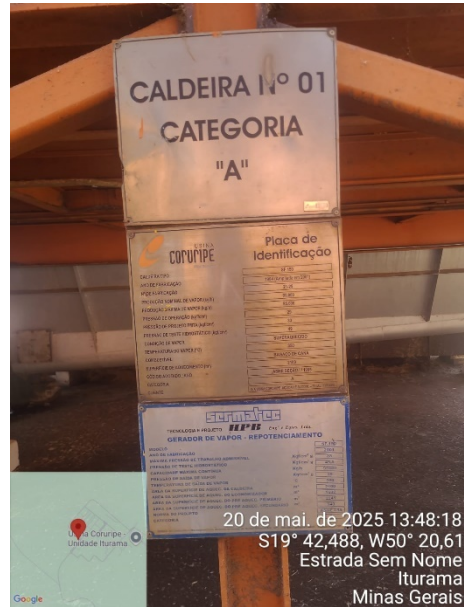
Nameplate data: Boiler nº 1 Iturama
