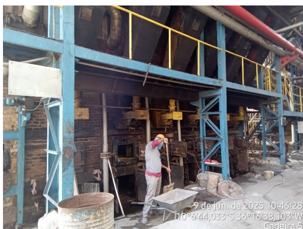
Boiler nº 5 Coruripe Usina (COR)
