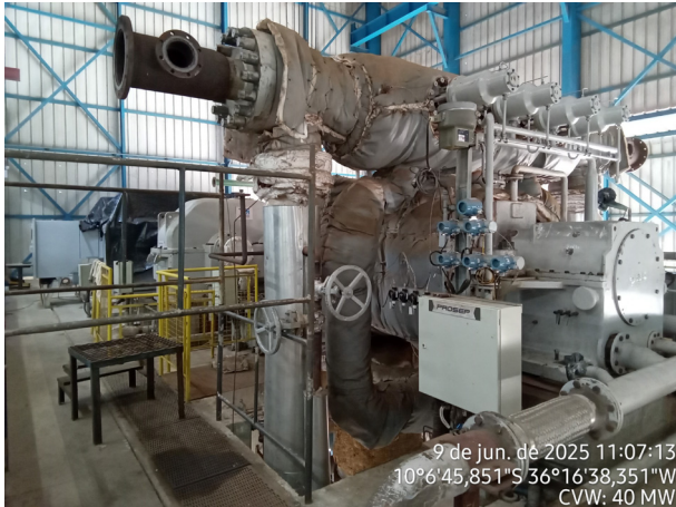
Alternator/ Generator nº 6 (UTE Coruripe CVW Energética)
