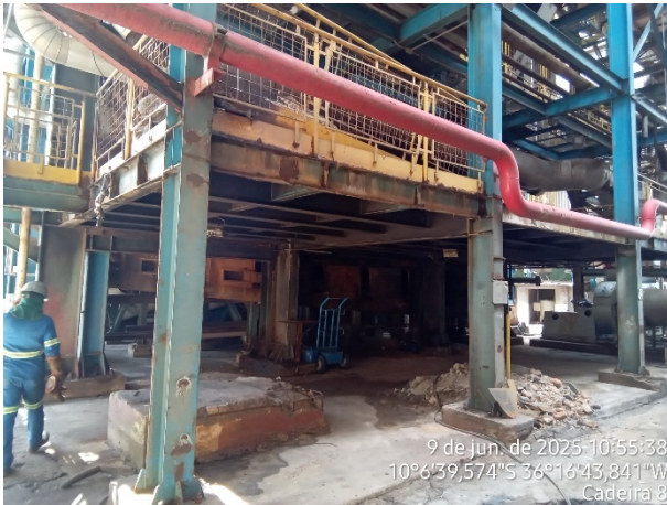
Boiler nº 8 Coruripe Energética (CVW)
