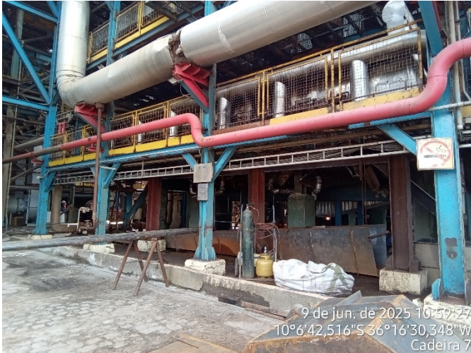
Boiler nº 7 Coruripe Usina (COR)
