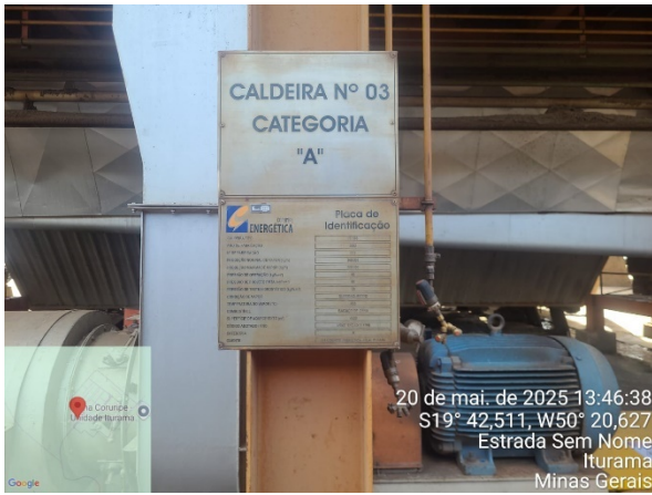
Boiler nº 3 Energética Iturama
