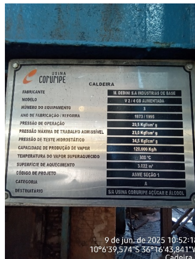
Nameplate data: Boiler nº 3 Coruripe Usina (COR)
